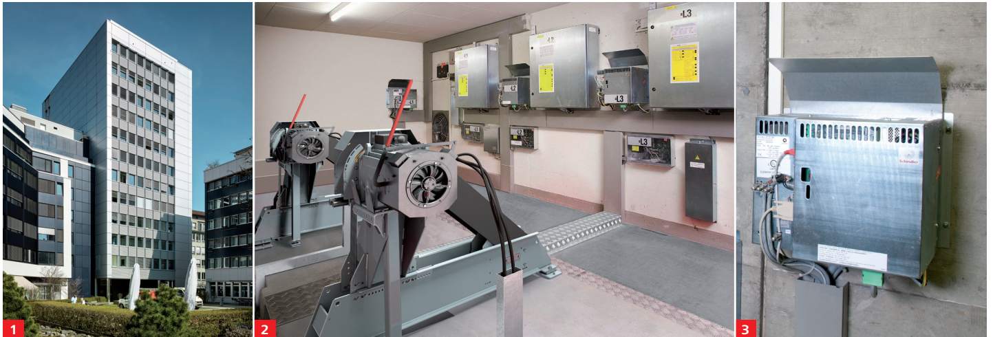
1 : Application usuelle dans un immeuble | 2 : Salle des machines | 3 : Convertisseur à récupération d'énergie
